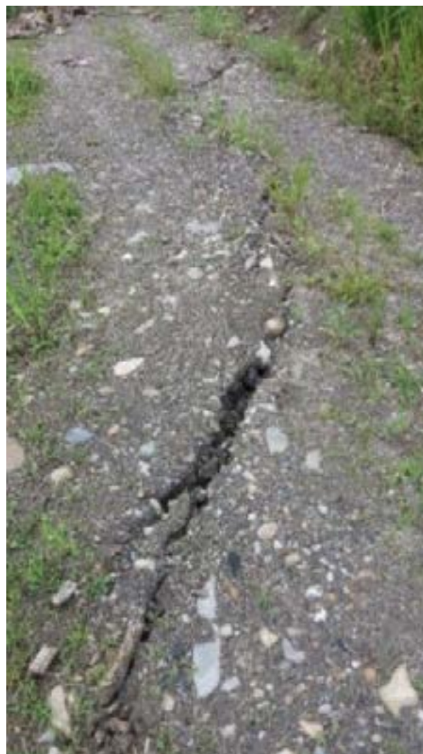
Foto 3: Grieta de tracción. Zona 4. Fuente: HIDROSANBARTOLO, 2017.
