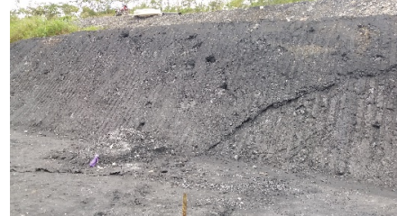
Figura 5. Huella de movimiento de ladera en talud. Zona No 5.
