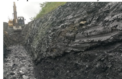
Figura 6. Huella de movimiento de ladera a 5 metros de profundidad. Zona 5.
