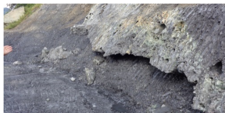
Figura 4. Huella de movimiento de ladera en talud. Zona No 6.
