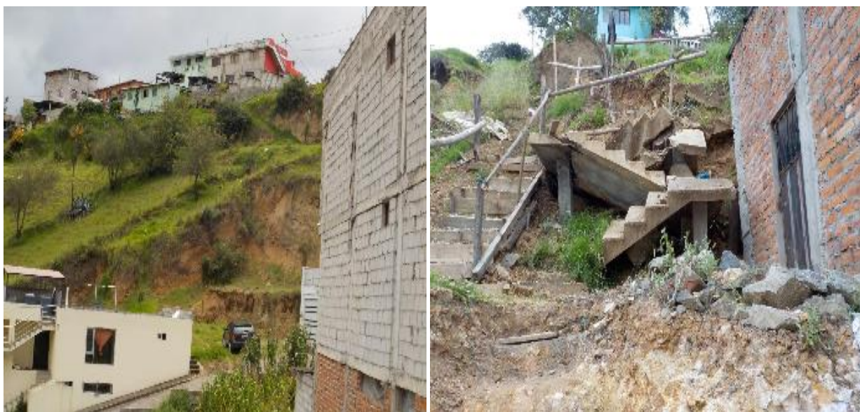
Figura 7. Corte de ladera para construcción de viviendas provoca taludes inestables en el barrio La Merced [2].
